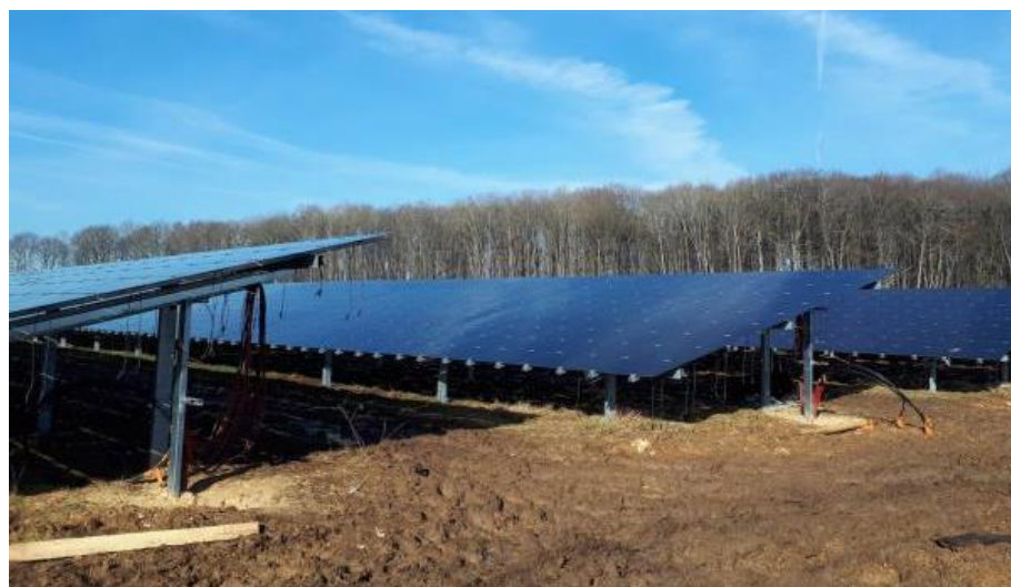
Figure 39 : Exemple de tables photovoltaïques (source : SIEGE 27, 2022)
